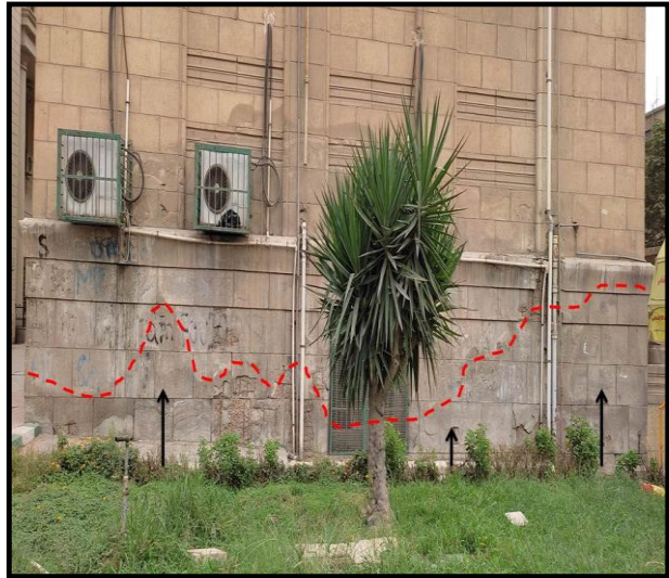
صوره(7)الطبقة الملحية على حوائط مبنى قسم الحيوان بجامعة القاهرة بفعل الرطوبة الأرضية الدراسة الميدانية: 2021-4-14
