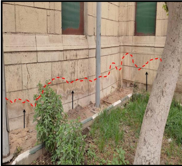
صوره(8)الطبقة الملحية على حوائط مبنى قسم نبات بجامعة القاهرة بفعل الرطوبة الأرضية الدراسة الميدانية: 2021-4-14
